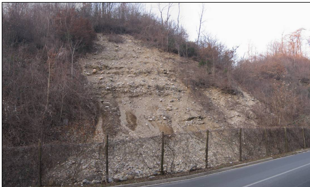
Figura 4.5: Dissesto lungo via Varese (002.SVd)
